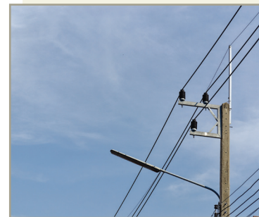
Fig. 33 – Linie electrică de transport de joasă tensiune
