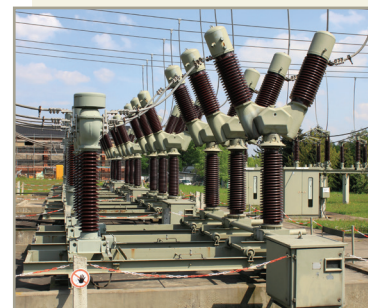
Fig. 35 – Stație electrică de transformare
