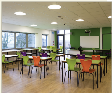
Fig. 27 – Instalație de iluminat în sala de clasă
