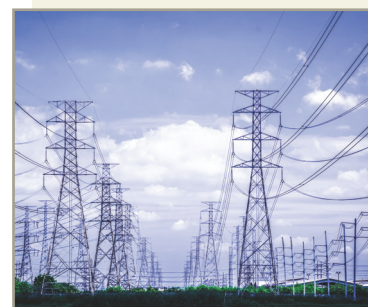
Fig. 34 – Linie electrică de transport de înaltă tensiune
