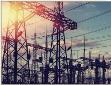
Fig. 31 – Stație de distribuție a energiei electrice
